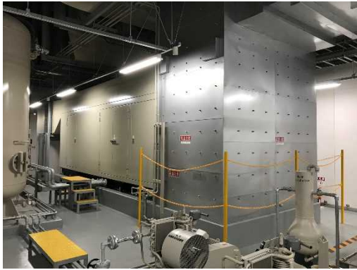
自家用発電機
